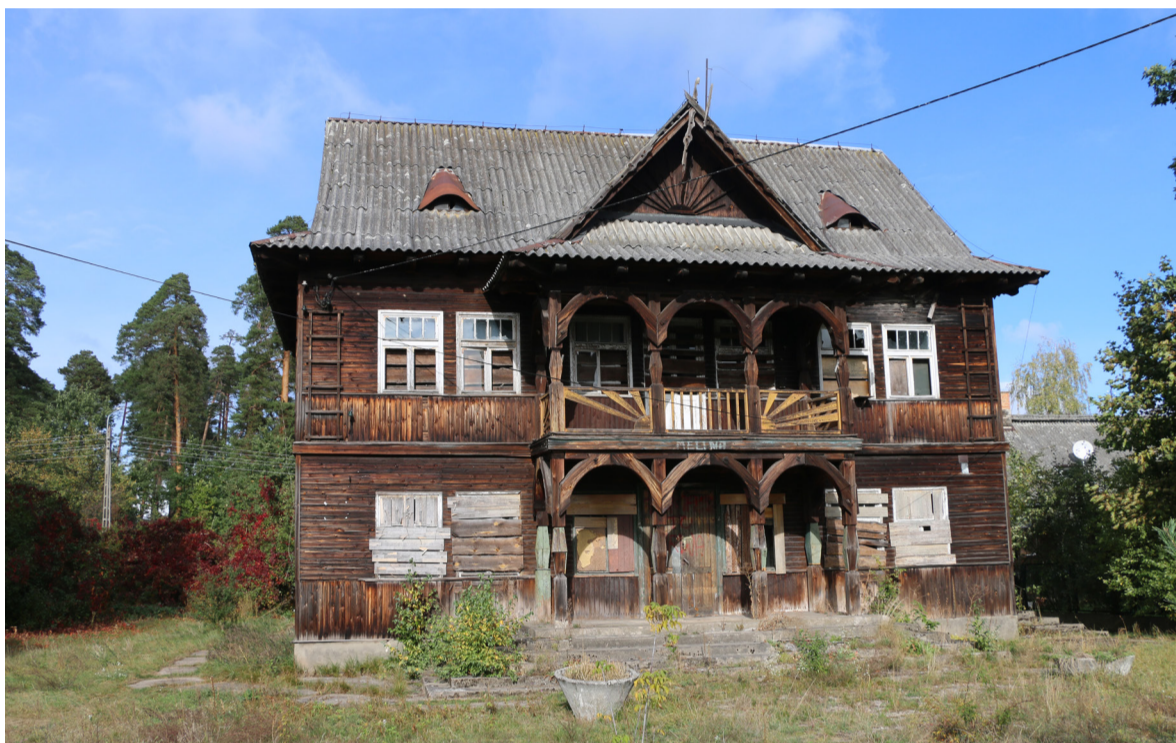
Fundacja Cordis obiecywała stworzyć w tym miejscu dom dziennego pobytu osób starszych wraz z opieką medyczną oraz świetlicę dla młodzieży. Niestety, nie udało się tego zrealizować. Zabytkowy budynek popada w ruinę.
